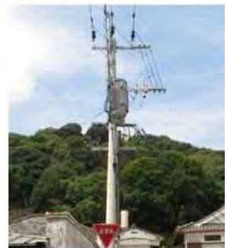
図-5 柱上設置型 (撮影：みち研)
