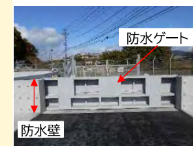
防水壁・防水ゲートの設置による変電所浸水対策
